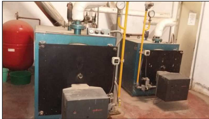
Vista de las calderas
