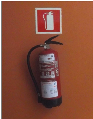
Extintor Polvo ABC
